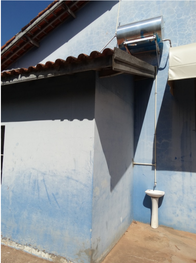
Vista do Boiler de 200 litros de armazenamento da água aquecida.
